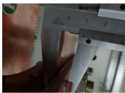
主开关进出线母排厚度照片
