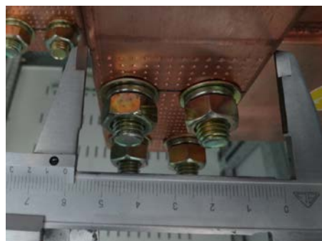
主开关进出线母排宽度照片
